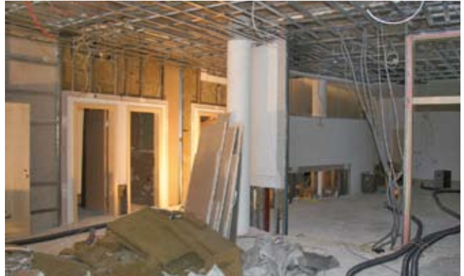
Zerstörte Fußböden, aufgeweichte Wände, einsturzgefährdete Decken, unbrauchbar gewordene Elektro- und Elektronikgeräte. Fotos: Rauh
